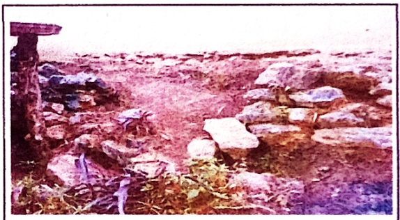
Foto 4: se observa el muro decaido, dejando familia ariesgado, se encuentra en mal estado.
