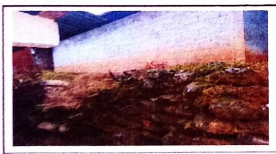
Foto 5: Se observa el muro decaido posterior de la escuela, se encuentra en mal estado.
