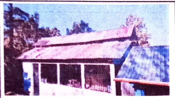
Foto 1: Se necesita el cambio de techo y costaneras, se encuentra en mal estado.
