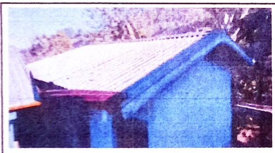
Foto 3: Se necesita el cambio de techo y costaneras, se encuentra en mal estado
