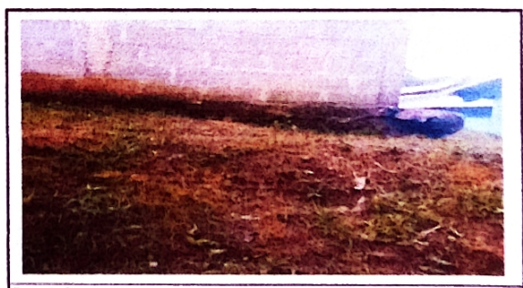
Foto 6: Se observa la escuela, hundiendo la tierra por la rampa, dejando en riesgo a las familias cercanas.
